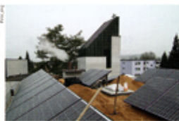
Solarspar-Anlage auf dem Dach des katholischen Pfarrhauses in Seuzach.
