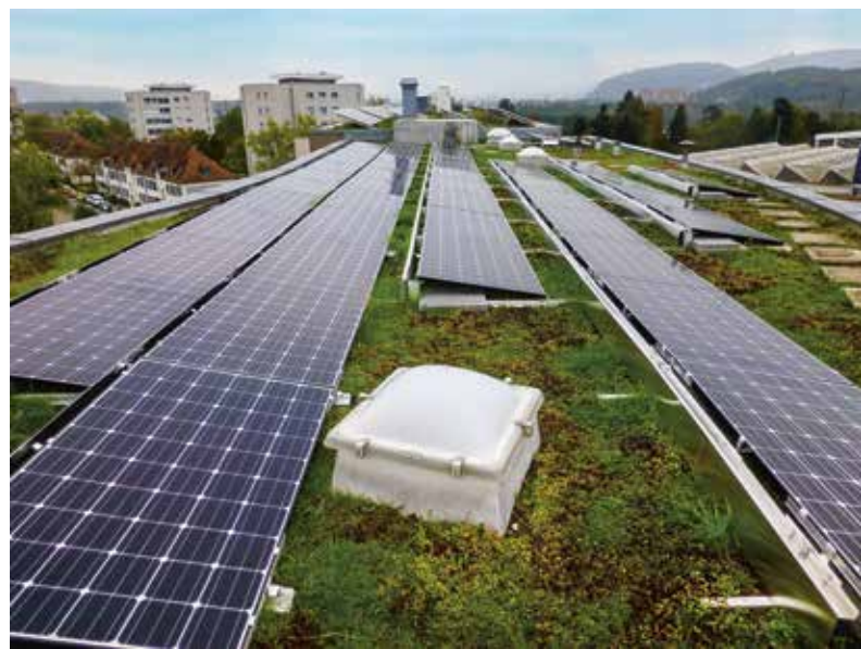
Nr. 57 macht an der Basler Münchensteinerstrasse aus Sonnenlicht sauberen Strom.
