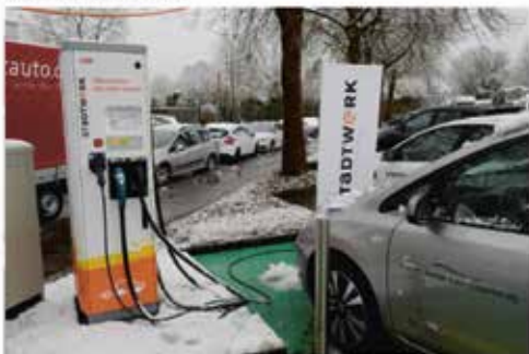
Die Elektro-Schnellladestation beim Tennis- und Squashcenter Auwiesen liefert einen Solarstrom. Bild: Heinz Biener
