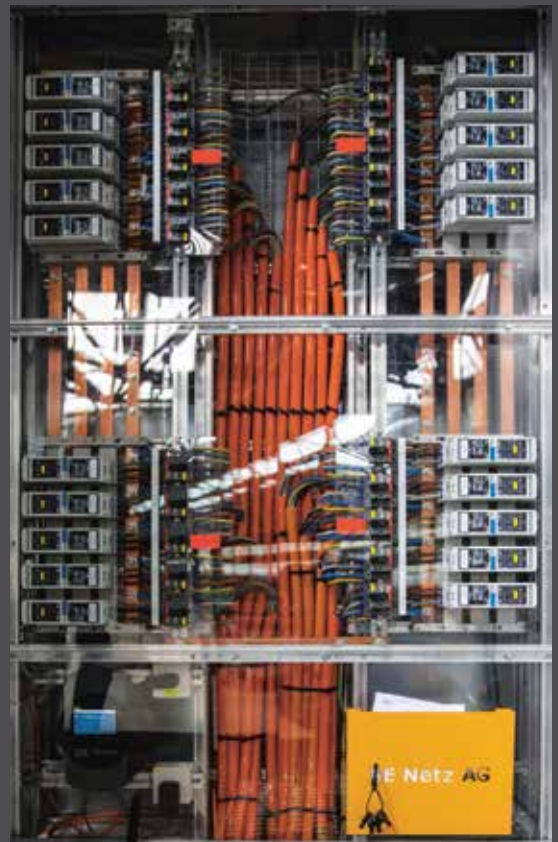
Detailansicht des Schaltschranks
