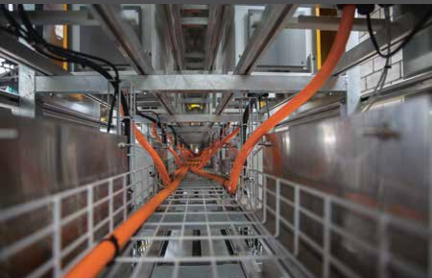
Detailansicht der Wechselrichter-Verkabelung
