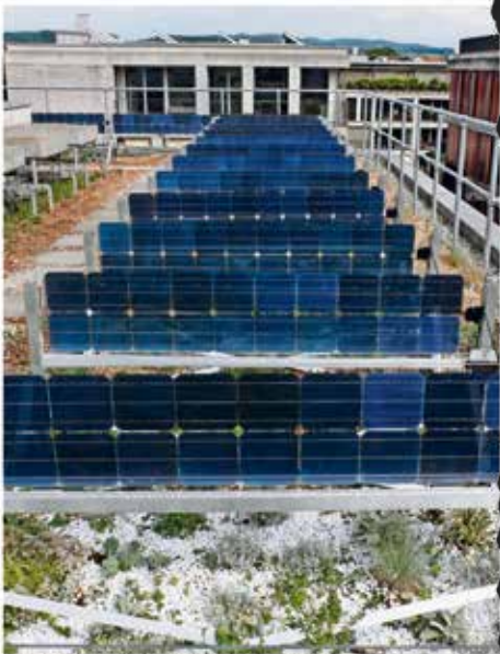
Bildungsbild: Die vertikal aufgestellten Solarpaneele auf dem Dach der Seniorenresidenz.
